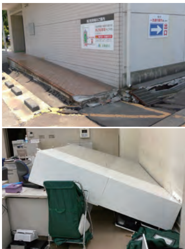
駐車場の隆起、店内のキャビネットが倒れる等の被害があった輪島支店
