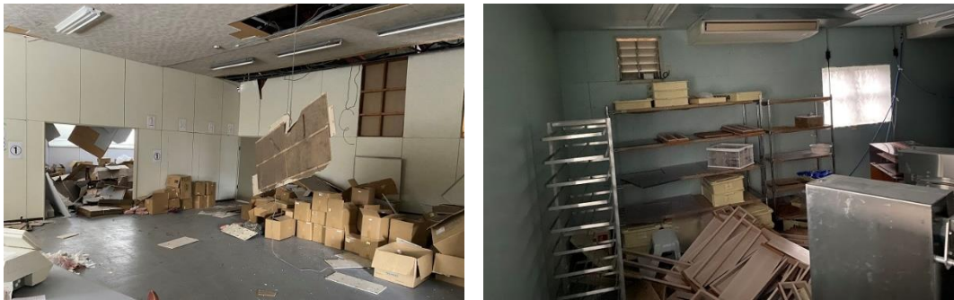
地震の被害を受けた加工場
